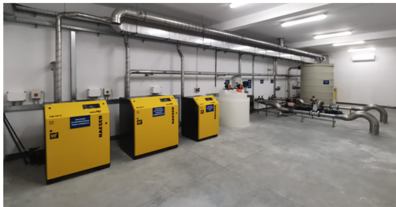
Wnętrze oczyszczalni ścieków w Bereźce.
