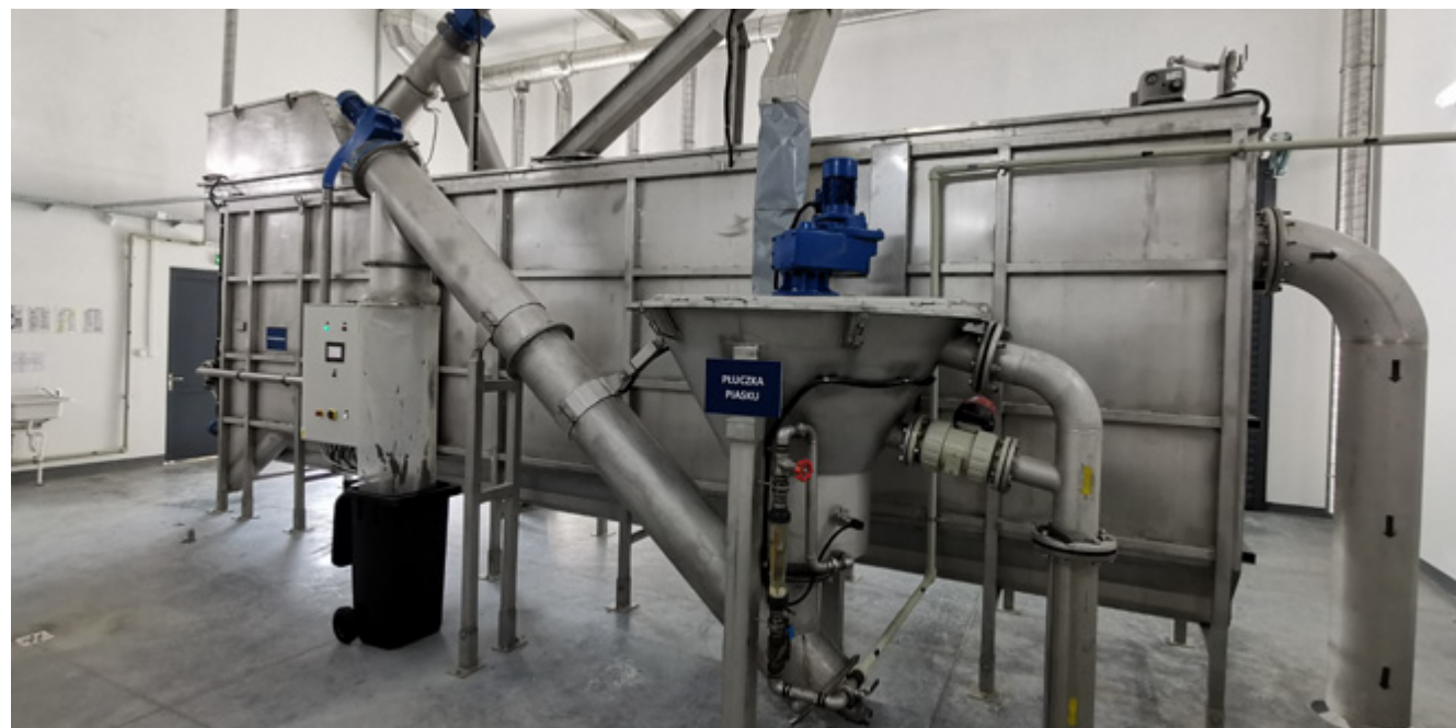
Płuczka piasku w oczyszczalni ścieków w Bereźce.
