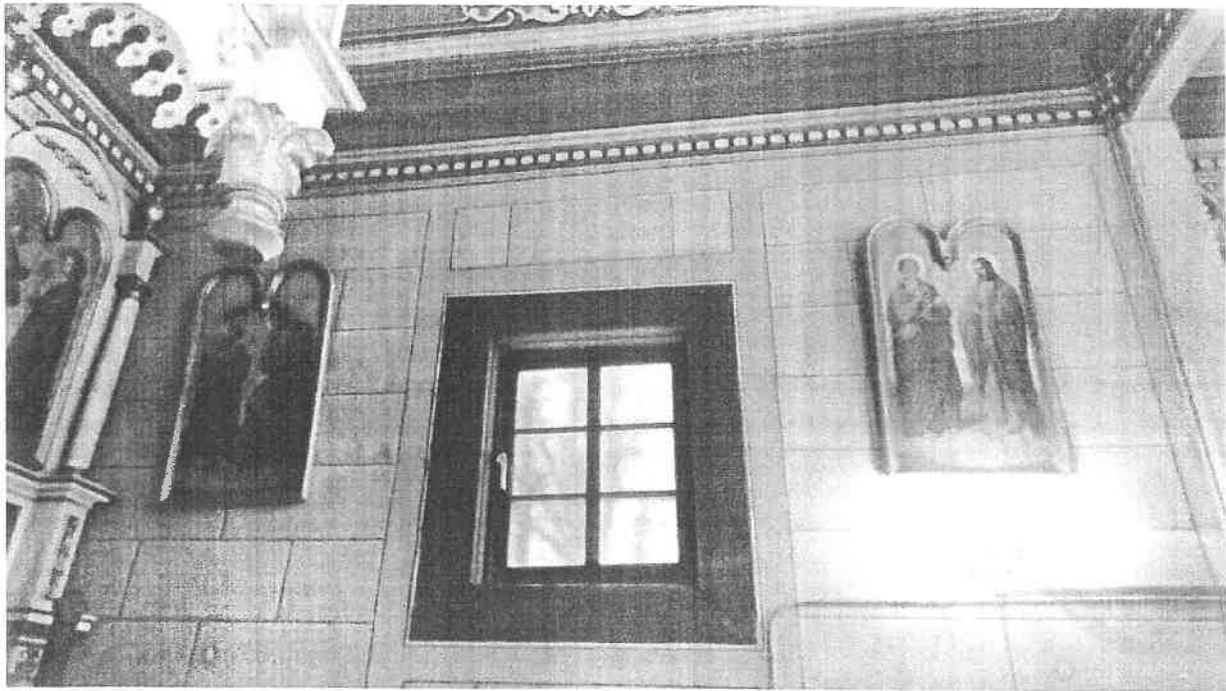
Fot. 7. Cerkiew pw. Mikołaja Cudotwórcy w Bereźnicy Wyżnej – widoczna wtórna polichromia ścienna powtarzająca pierwotne podziały architektoniczne. Stan przed konserwacją. Fot. Izabela Michalik, luty 2023
