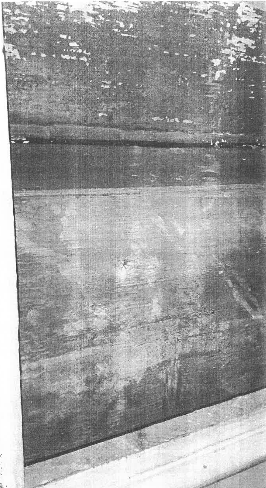
Fot. 8. Cerkiew pw. Mikołaja Cudotwórcy w Bereźnicy Wyżnej – zbliżenie na fragment pierwotnej polichromii ściennej zachowanej na ścianie ołtarzowej za ikonostasem przedstawiający marmoryzację; w górnej partii widoczne łuszczące się warstwy malarskie oraz liczne ubytki warstwy zaprawy i warstwy malarskiej. Stan przed konserwacją. Fot. Izabela Michalik, luty 2023
